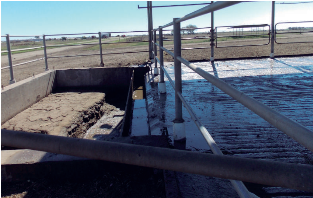
Foto 20: Almacenamiento de estiércol sobre piso de concreto con pendiente para lixiviados hacia la laguna.
